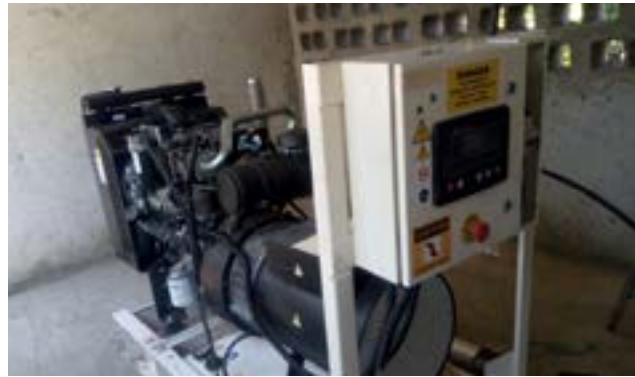
Il generatore installato presso il Centro San Raffaele di Gondar
